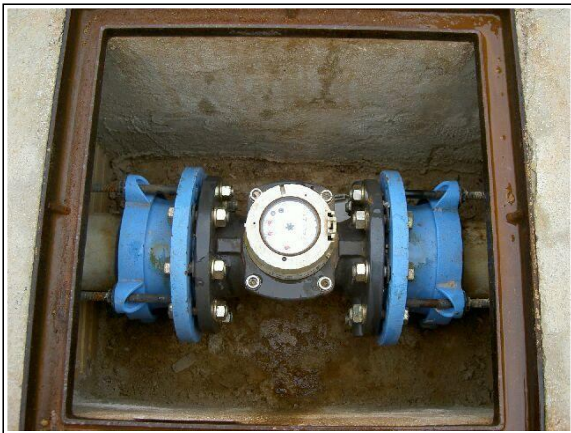
Freginals.Set Piques.Detalle contador (Inv. aba stec. Im portada automática) (01/01/2008)
