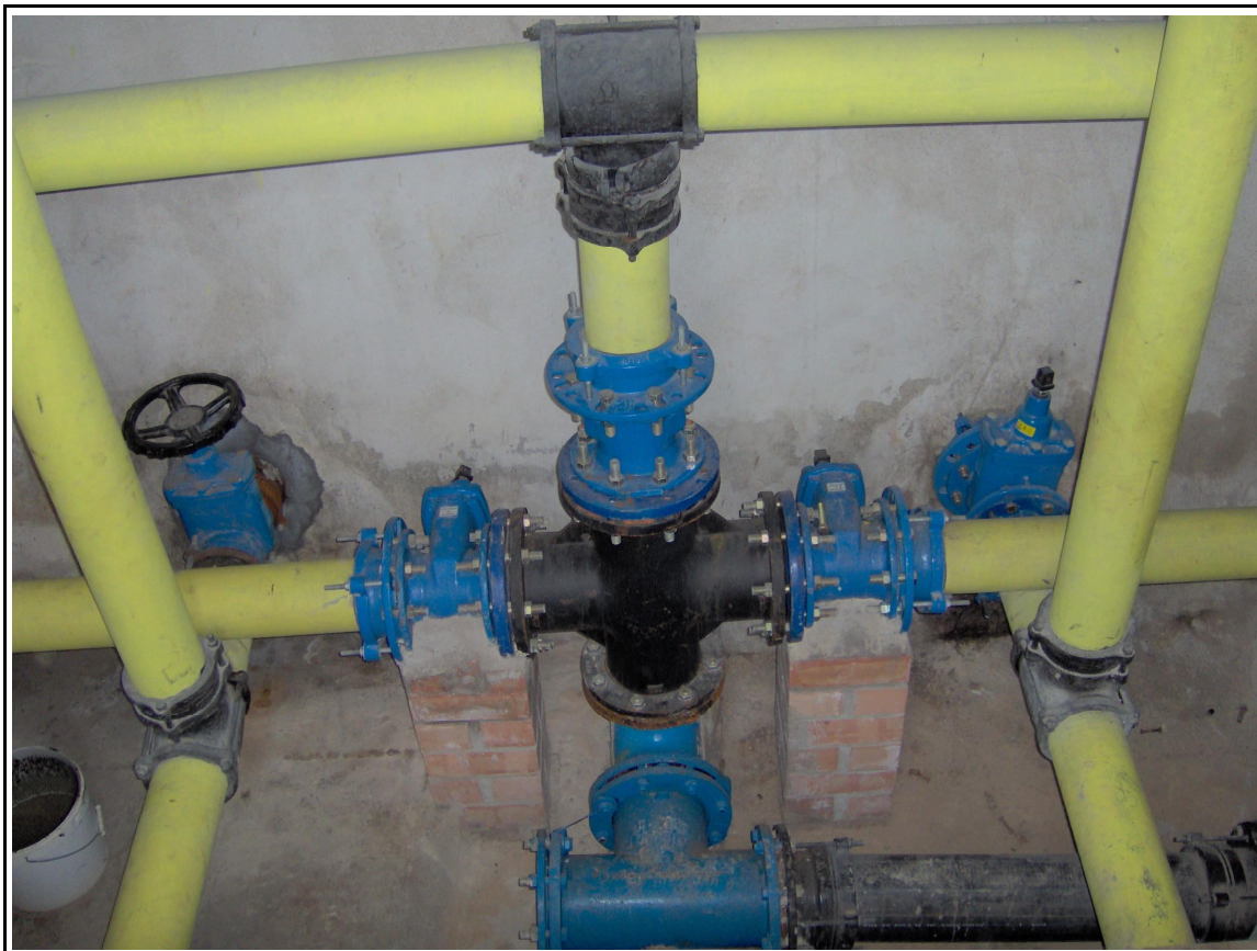
Tuberías que comunican los dos depósitos (16/11/2006)
