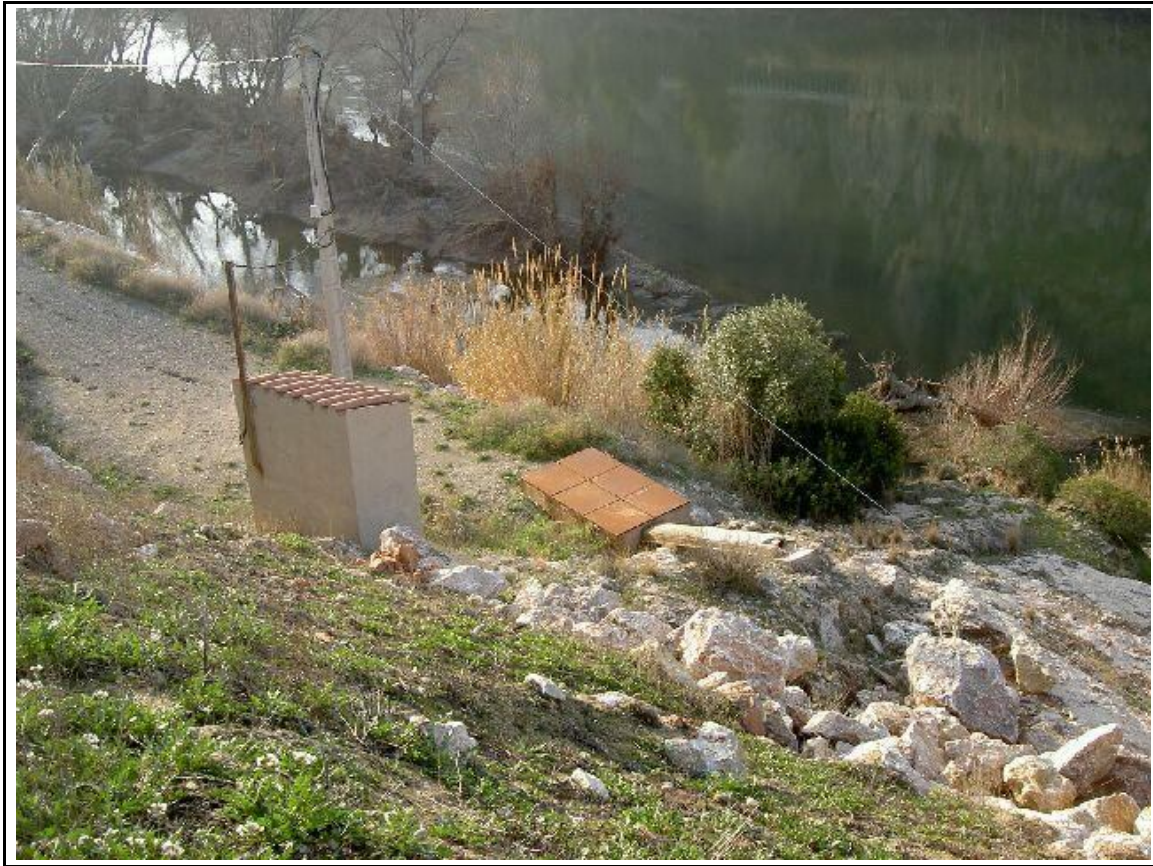
Vinebre.Pou Veanta.situación pozo (Inv. abastec. Importada automáticamente) (01/01/2008)
