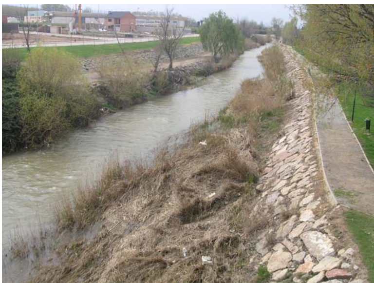
Ribera muy deteriorada en otro proceso de urbanización fluvial, el río Alhama en Alfaro. Foto: Alfredo Ollero.
