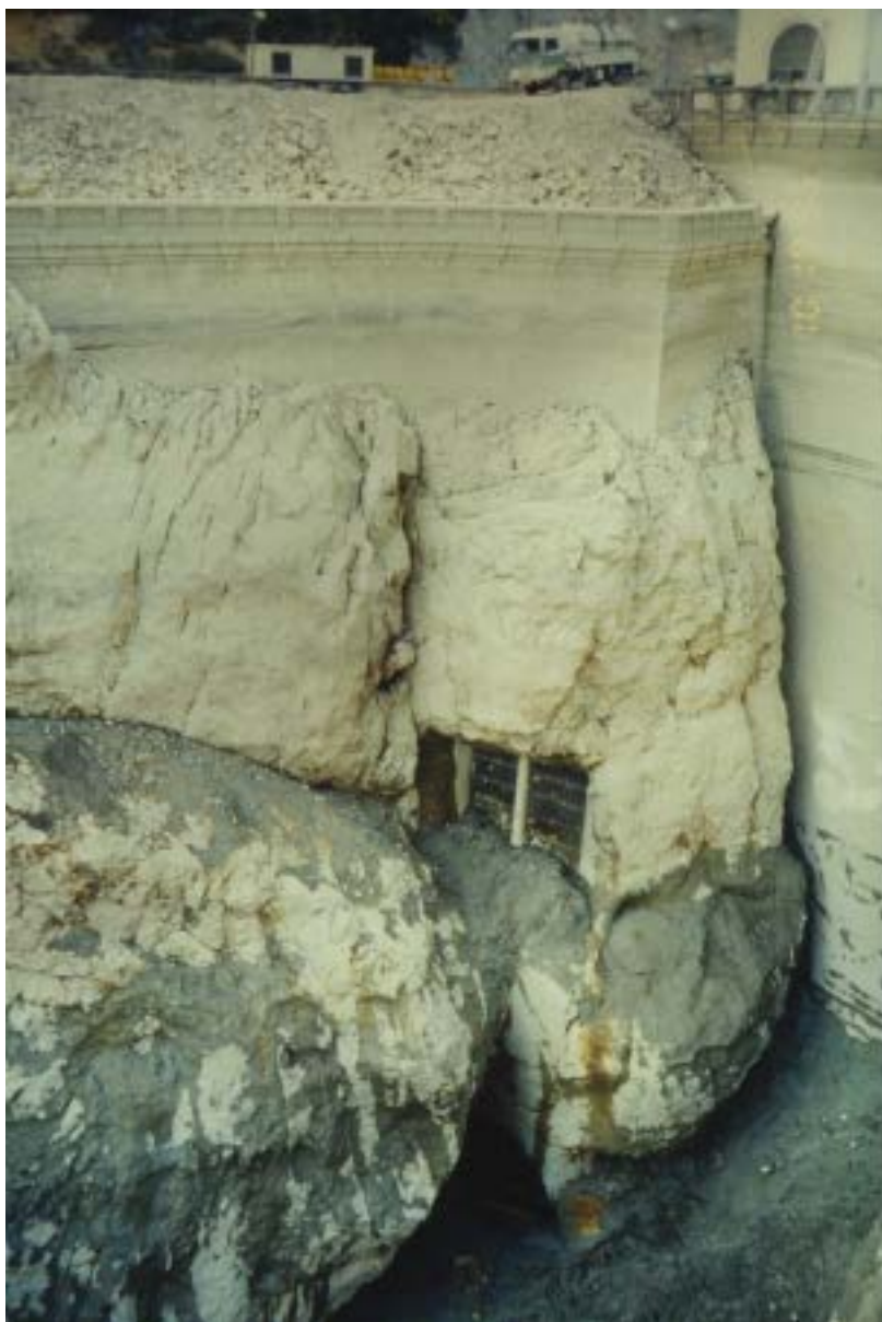
Figura 5.14. Acumulación de sedimento en las inmediaciones de la presa de Barasona. (Cortesía de D. Rafael Romeo, CHE).
