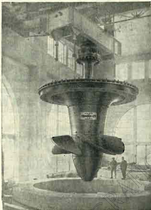
Turbina Kaplan, de 30.000 HP. - Central de Kembs sobre el Rhin
