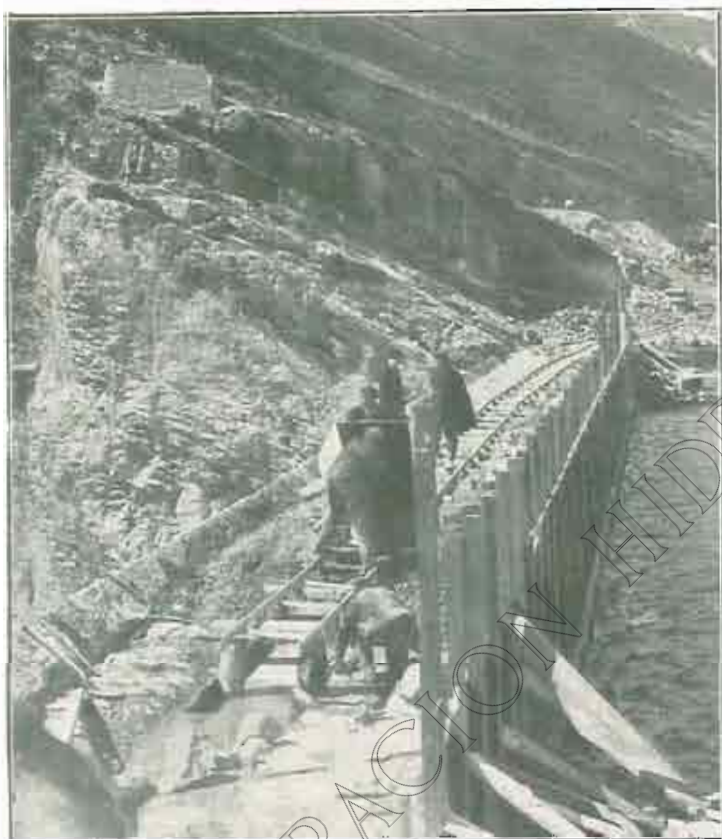
Estado de las obras de recrecimiento del Pantano de Arguis, en Abril de 1928.
