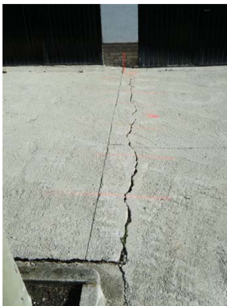
Figura 56. Grieta en el pavimento. Puntos de lectura 4 y 90.
