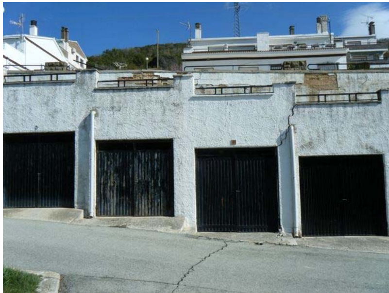
Figura 57. Grieta en el pavimento y daños en garajes. Puntos de lectura 97.
