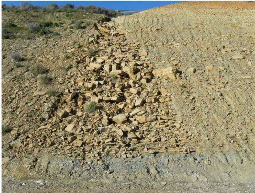
Figura 60. Situación del flanco oeste del deslizamiento en afloramiento del macizo rocoso. Punto de lectura 36.
