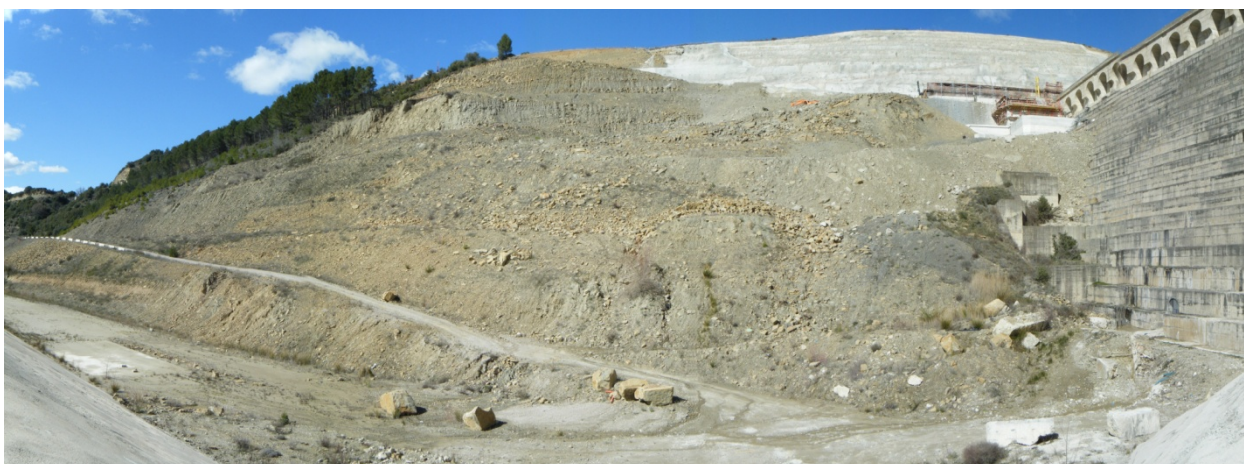
Figura 82. Panorámica de la zona baja de la ladera, al Oeste de la presa
