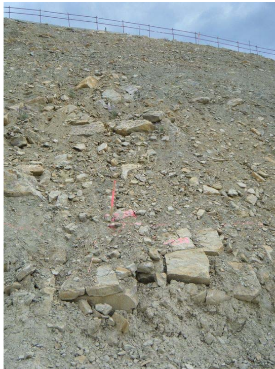
Figura 76. Detalle del afloramiento en la zona con posible decompresión y deformación del macizo rocoso. Punto de lectura 123.
