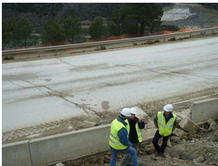
Figura 67. Grietas en la calzada que marcan el flanco este. Punto de lectura 6.
