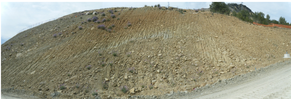
Figura 75. Zona con posible decompresión y deformación del macizo rocoso sin que se haya llegado a perder la estructura general de la ladera. Punto de lectura 120.
