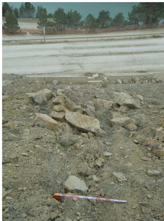
Figura 72. Grieta entre capas. Punto de lectura 113.
