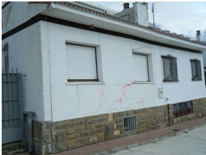
Figura 58. Grietas en edificación. Puntos de lectura 3 y 95.
