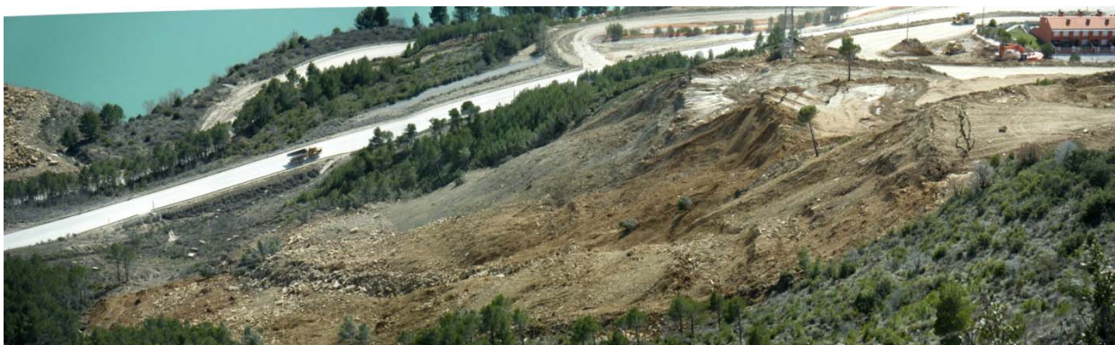
Figura 52. Nuevos depósitos controlados de productos provenientes de la excavación al este de la ladera de la margen derecha
