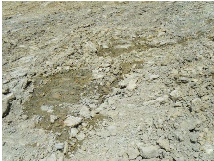
Figura 117. Pequeño rezume de agua en tramo con predominio de margas y en la zona alta de la ladera. Punto de lectura 54
