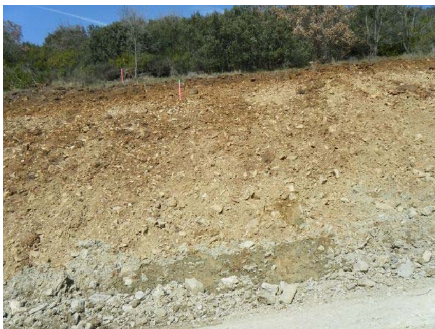
Figura 118. Filtración asociada al contacto suelo coluvial – margas, en la zona alta de la ladera. Punto de lectura 64
