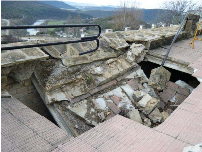
Figura 59. Hundimiento en el pavimento. Puntos de lectura 3 y 95.
