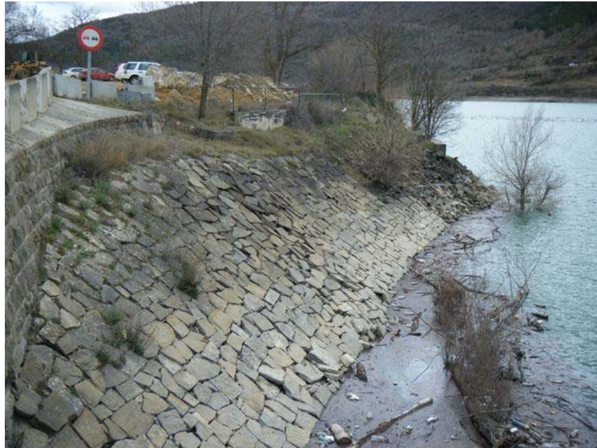
Figura 80. El pie de la ladera está cubierto por el agua. El muro de mampostería presenta algunas roturas
