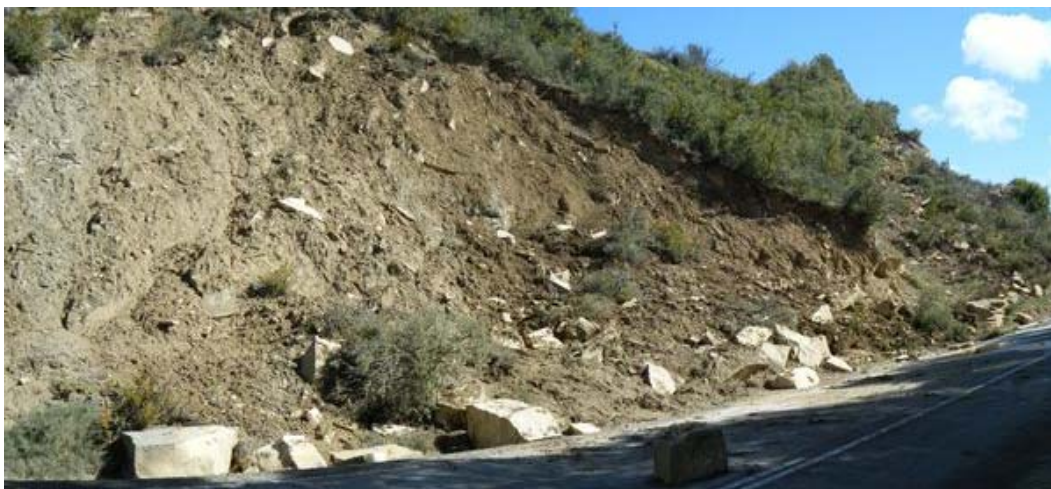
Figura 49. Deslizamiento reciente en talud excavado en los suelos de coluvial con bloques
