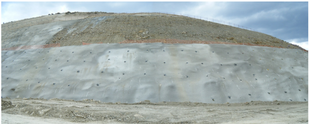
Figura 25. Excavaciones y refuerzo del talud, aguas arriba (al este) del eje de la presa.
