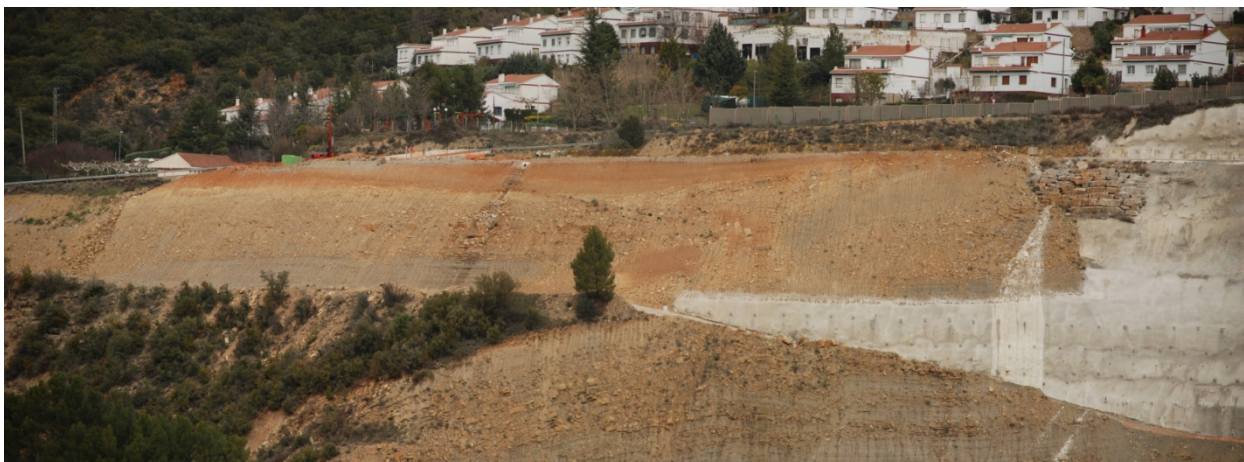
Figura 62. Panorámica del terreno al Este de la rotura que marca el flanco Oeste en el talud. El sustrato, que está dentro de la zona inestable, marca una transición de las capas hacia suelos coluviales, hasta que aparece cubierto por los muros realizados para la obra de recrecimiento de la presa.
