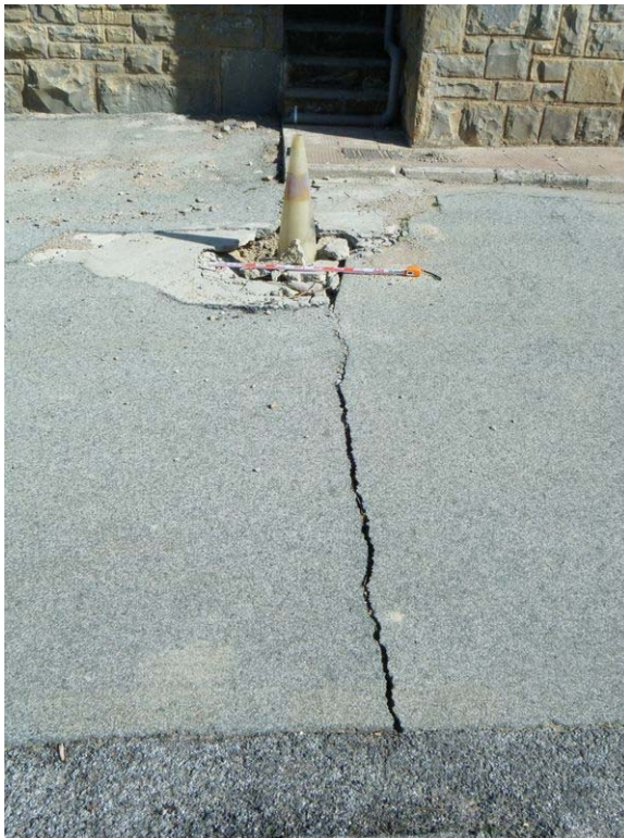
Figura 63. Grieta en el pavimento y pequeño hundimiento. Alineación de grietas al este de las grietas del flanco Oeste principal. Punto de lectura 98.
