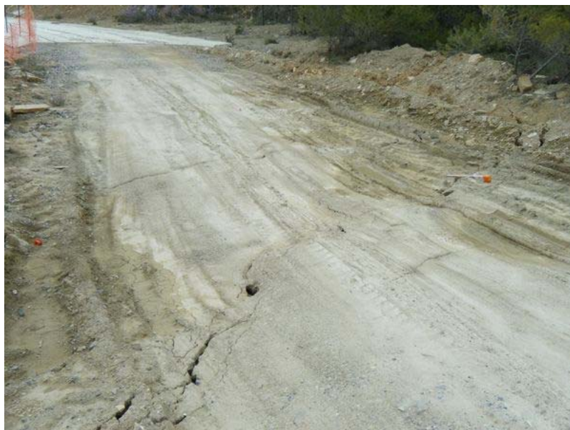
Figura 69. Grietas del flanco este en la pista existente. Punto de lectura 115.
