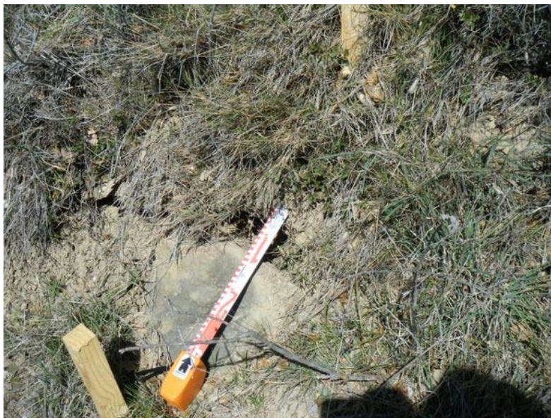
Figura 65. Detalle de una de las pequeñas grietas de la zona alta de la ladera. Punto de lectura 52.
