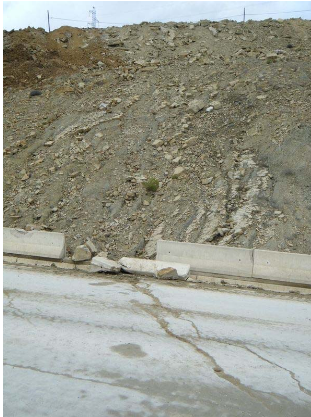
Figura 68. Continuidad entre las grietas en la calzada y el afloramiento del talud. Punto de lectura 6.
