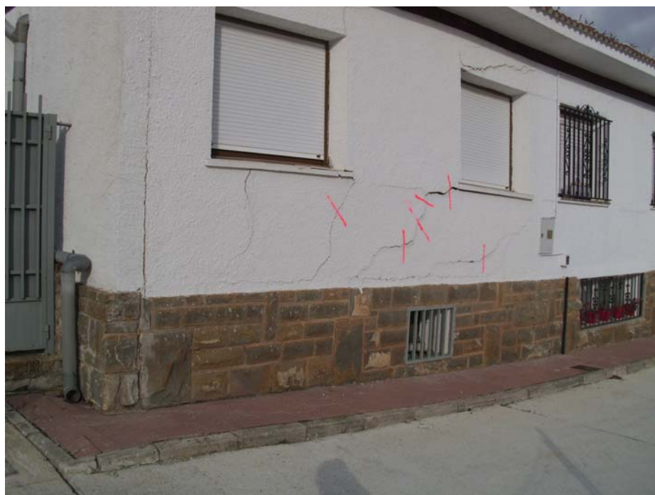
Figura 3.21: Vista de la fachada exterior de la vivienda nº 20, situada en la calle 3 de la Urbanización Lasaitasuna, coincidiendo con el límite Oeste de la masa inestable. Esta vivienda ha sido claramente afectada por el movimiento diferencial que se ha producido en el terreno al situarse en el límite del deslizamiento. Las viviendas que se encuentran dentro o fuera de la masa inestable no presentan daños de consideración similar.
