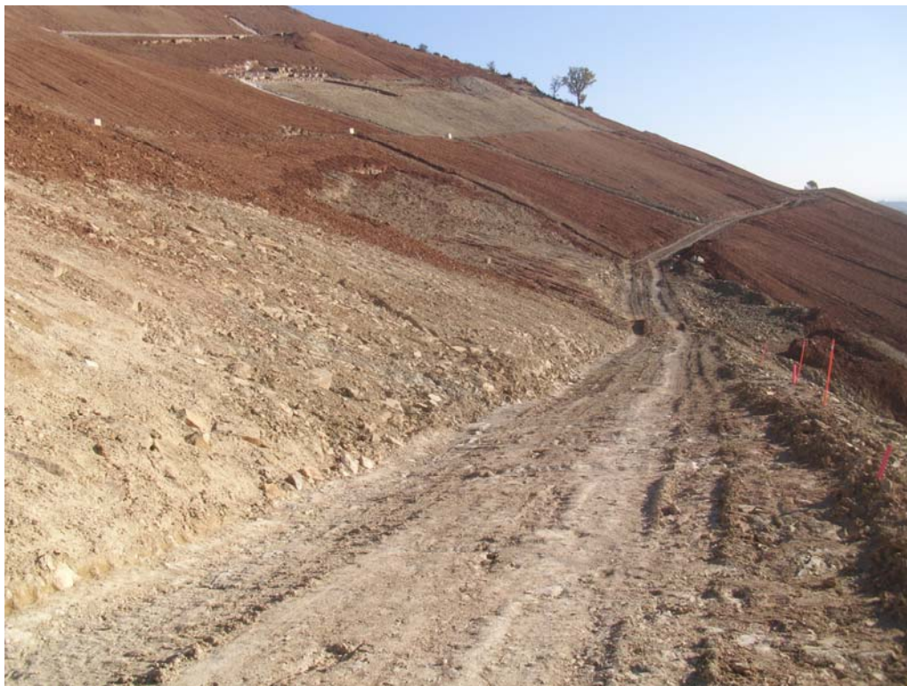
Figura 3.49: Vista de la berma nº 3 hacia el Este, la cual se ve afectada por un deslizamiento somero desarrollado tras la excavación, a favor de una zona de mayor alteración.
