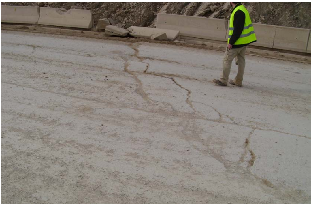
Figura 3.5: Límite Este de la masa inestable definida por la superficie de rotura principal SPR, marcada con claridad en la carretera N-240. Se observa una grieta que sigue la proyección de la estratificación sobre la superficie horizontal de la calzada.
