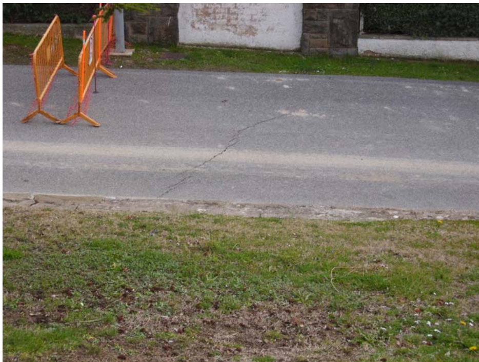
Figura 3.14: Límite Oeste de la masa inestable definido por una grieta en el vial inferior (calle 1) de la Urbanización Lasaitasuna.
