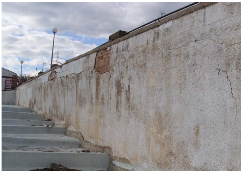
Figura 3.20: Vista de la pared de ladrillo sobre la que apoyan las viguetas del forjado que constituye la acera de la calle 3 de la Urbanización Lasaitasuna, coincidiendo con el límite Oeste de la masa inestable. Se observa el cabeceo de la coronación de la pared, coincidiendo con la zona en la que se ha producido el hundimiento de la acera.
