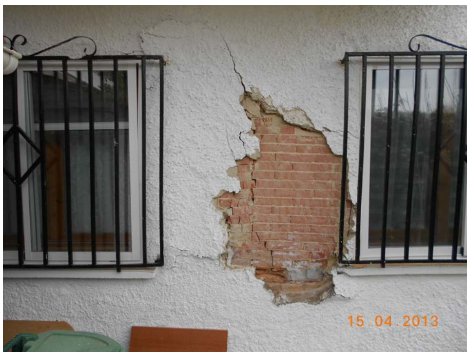
Figura 3.28: Detalle de los daños provocados por la grieta intermedia en la fachada del patio de la vivienda situada entre las calles 3 y 4. Se observa como la fachada de la casa está constituida por ladrillos huecos con enfoscado de cemento.
