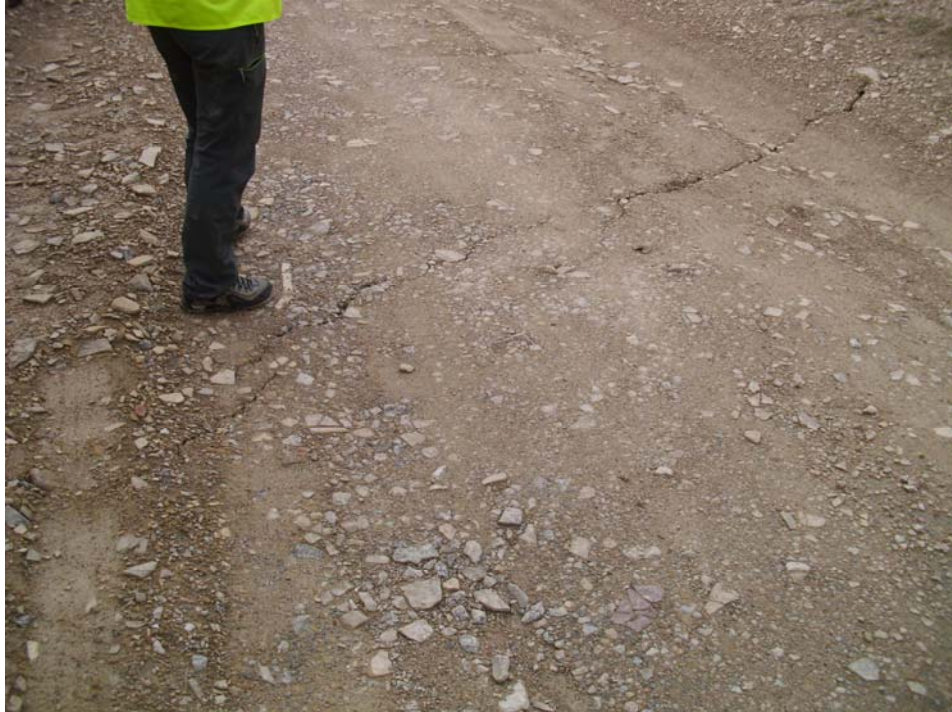
Figura 3.6: Límite Este de la masa inestable delimitada por la superficie principal de rotura SPR, que se observa en el camino bajo la carretera N-240. Puede verse una grieta que sigue la proyección de la estratificación sobre la superficie horizontal del camino.
