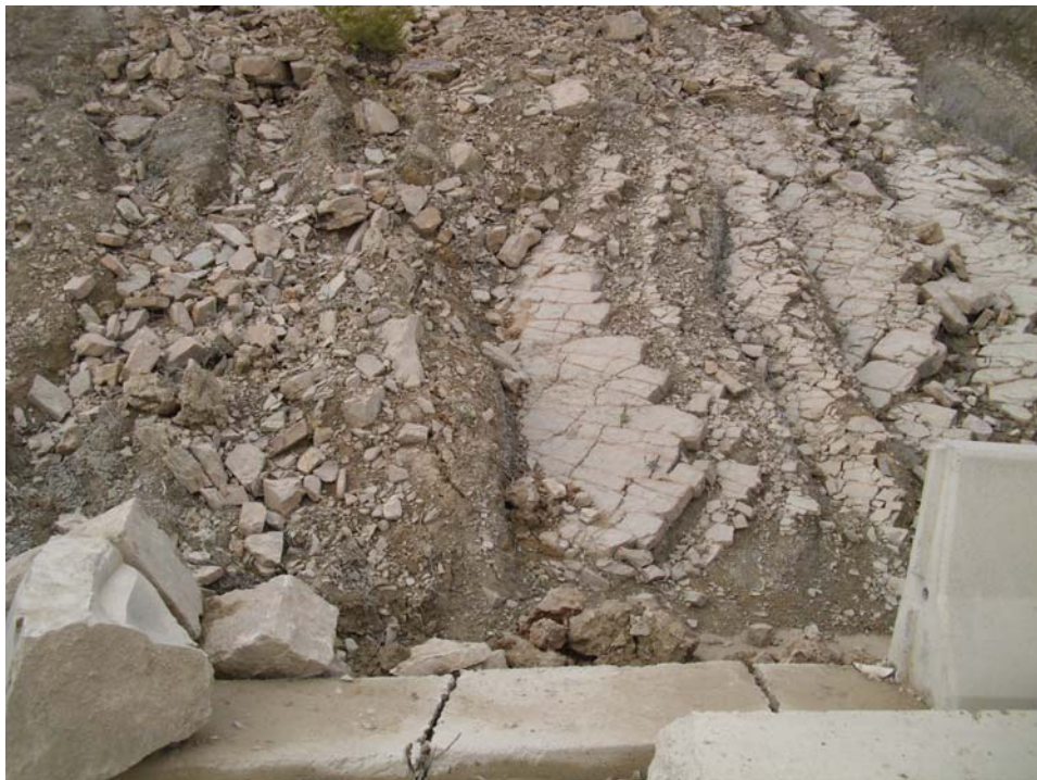
Figura 3.7: Límite Este de la masa inestable delimitada por la superficie principal de rotura SPR, que provoca la rotura en un bordillo de la carretera N-240. El límite de la rotura se sitúa en el Flysch próximo al contacto con las Margas de Pamplona, en el talud de la propia carretera.
