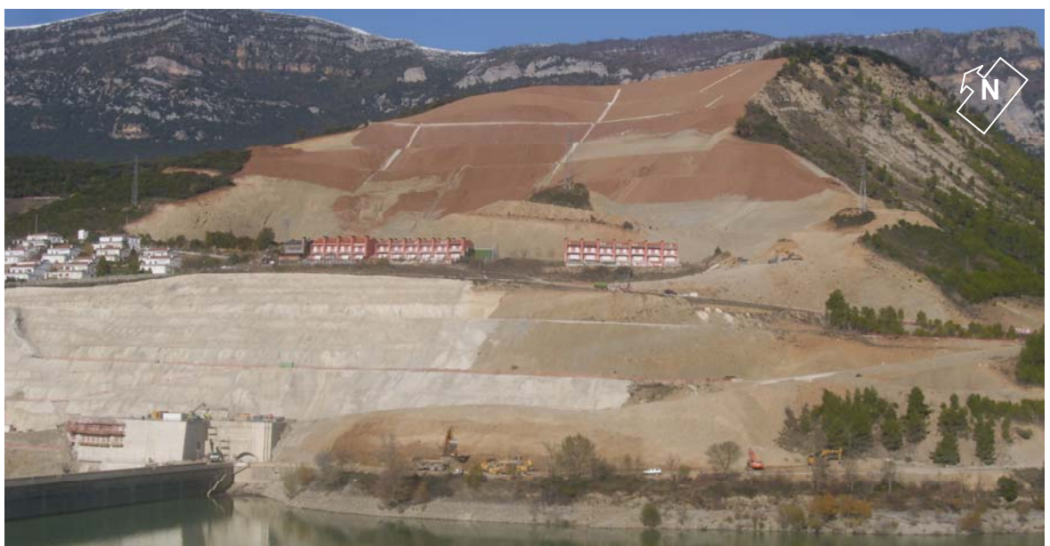
Figura 4.2: Vista frontal de la ladera en la que se han llevado a cabo los análisis de estabilidad que a continuación se exponen. Situación de las obras de estabilización a finales de noviembre de 2013.
