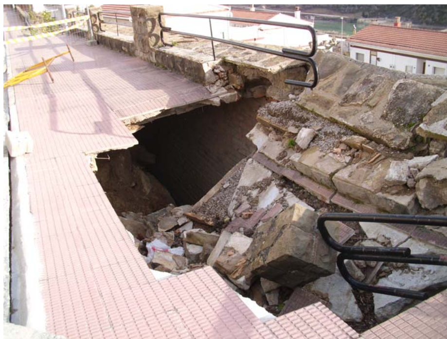
Figura 3.19: Hundimiento de una acera en la calle 3 de la Urbanización Lasaitasuna, coincidiendo con el límite Oeste de la masa inestable. Se observa como la acera consiste en un forjado de viguetas de hormigón, apoyado en una pared de ladrillos, y bajo el que no se dispuso en su día de un relleno (posiblemente porque la pared de apoyo no hubiera resistido el empuje de las tierras).
