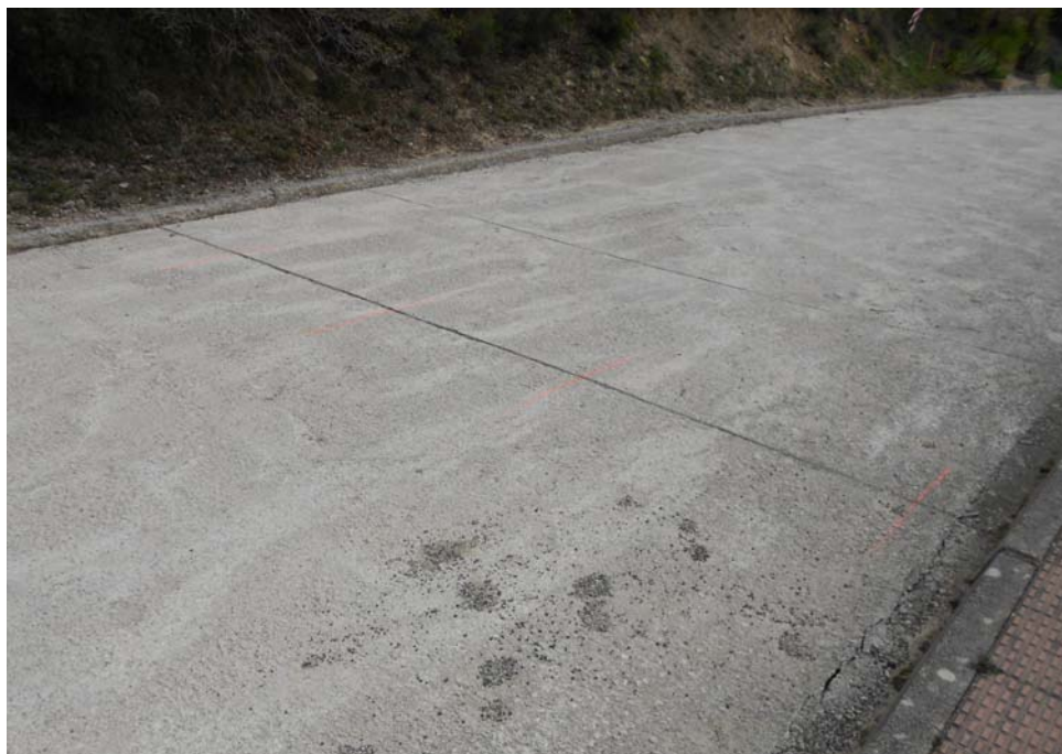
Figura 3.25: Apertura de una junta de hormigonado en la calle 4, a una distancia de 30 m al Este de la grieta de la figura 3.23 (la que define el límite Oeste de la masa movilizada) y a 20 m al Oeste de la grieta intermedia mostrada en la figura 3.24.
