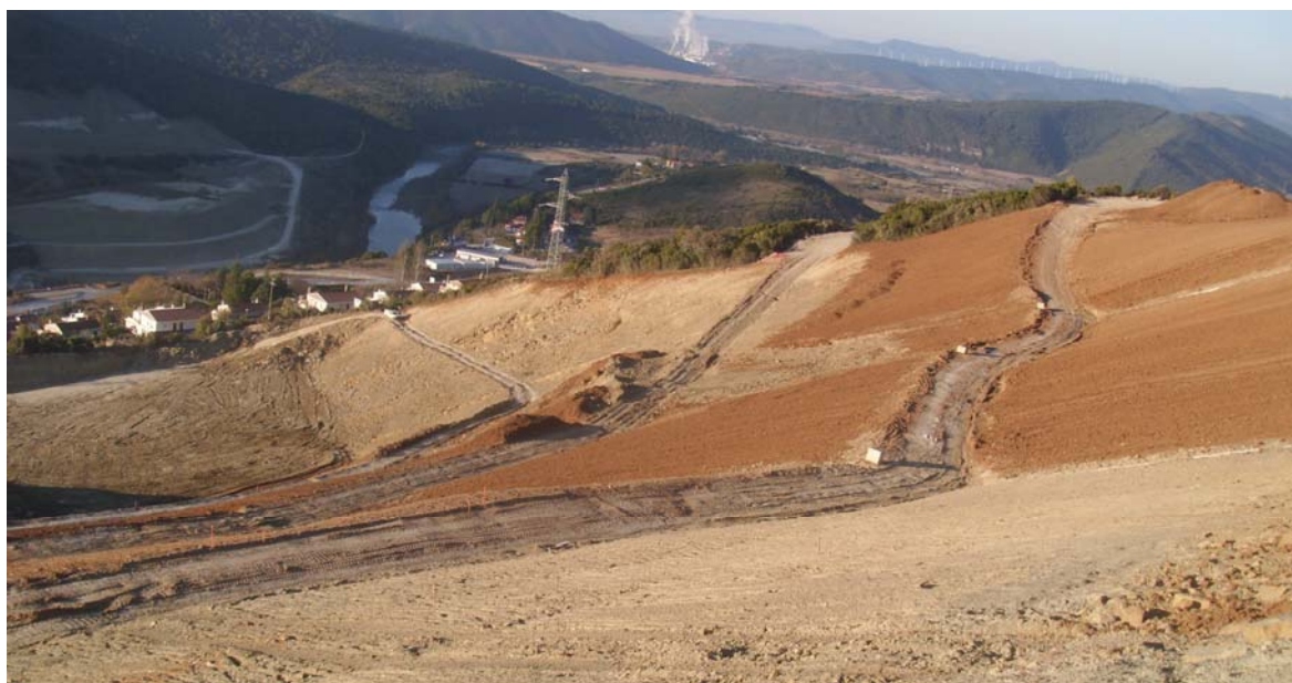
Figura 3.44: Vista hacia el Oeste de las bermas nº 3 y nº 4, y de los bancos nº 3 y nº 4, los cuales se ven afectados por un proceso de inestabilidad superficial.
