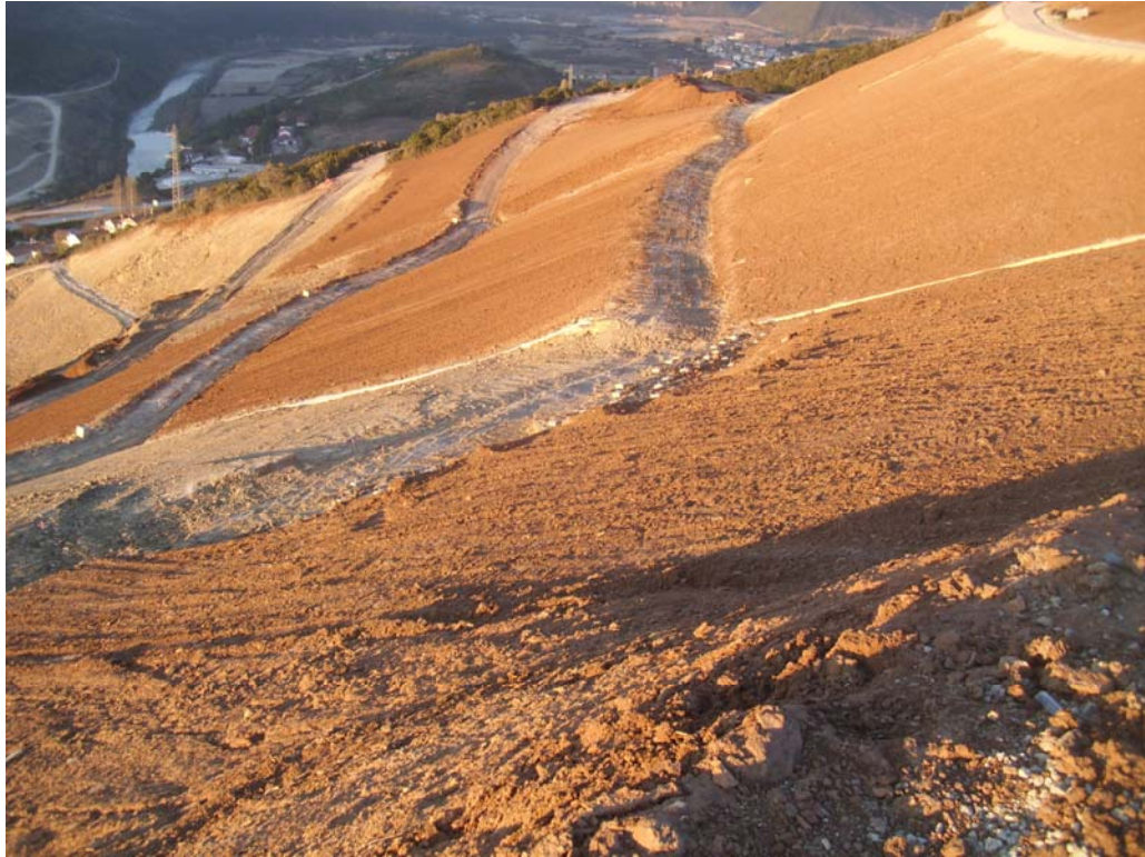
Figura 3.41: Vista hacia el Oeste de la berma nº 5 en primer término y los bancos nº 5 y nº 6.
