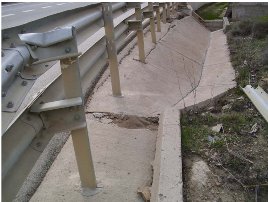
Figura 3.11: Límite Oeste de la masa inestable, que provoca la rotura de la cuneta de la carretera N-240. En la calzada no se ve una grieta transversal, si bien se observa la apertura de la calzada a lo largo de una junta longitudinal del aglomerado (figura 3.12).
