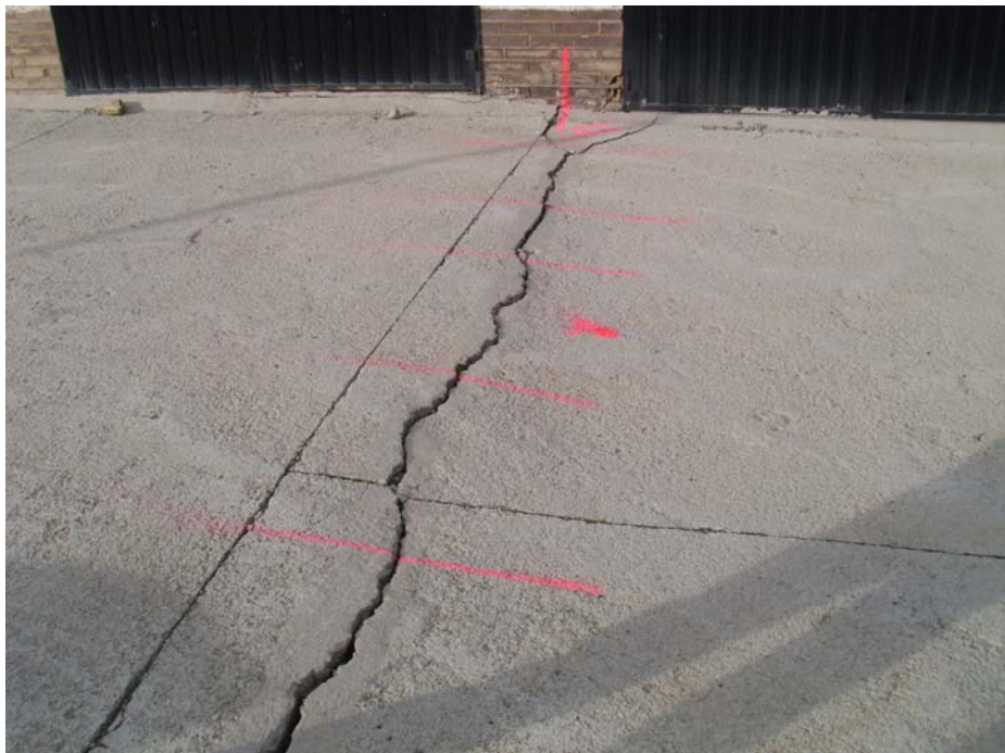
Figura 3.23: Vista de la grieta transversal observada en le calle 4 de la Urbanización Lasaitasuna, prolongación de la observada en la calle 3 y que afecta a la vivienda nº20. Se observa un salto lateral de unos 3 cm y un salto vertical de 1 cm. Se trata de una grieta que ya se encontraba rejuntada anteriormente y en la que se ha producido una reapertura mayor. Límite Oeste del deslizamiento.
