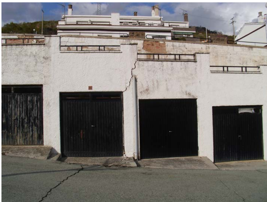
Figura 3.17: Límite Oeste de la masa inestable que provoca apertura de una grieta en el vial intermedio de la Urbanización Lasaitasuna y en unos garajes.
