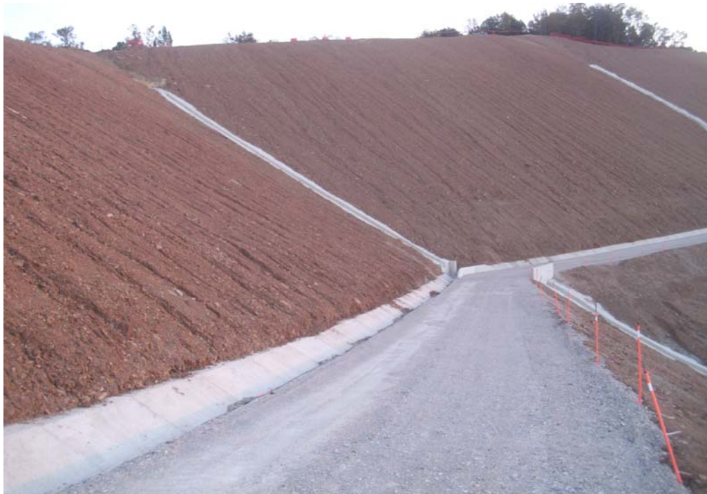
Figura 3.39: Vista hacia el E de la berma nº 7 y el banco nº 8. Coronación de la excavación. La berma se encuentra revestida de zahorra y se han ejecutado las cunetas de berma y bajantes.
