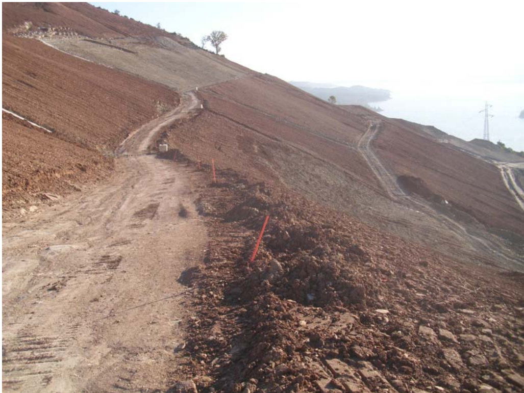
Figura 3.46: Detalle de la berma nº 4 hacia el Este, donde se sitúa la coronación del deslizamiento superficial observado.
