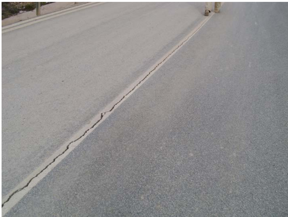
Figura 3.12: Límite Oeste de la masa inestable que provoca la apertura de la calzada a lo largo de una junta longitudinal del aglomerado. El hecho de no observarse con claridad el límite lateral de la masa movilizada muestra la escasa actividad del movimiento observado.
