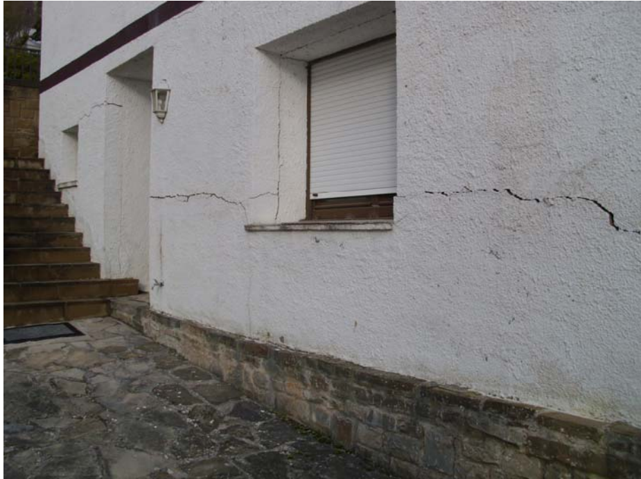
Figura 3.22: Vista de la fachada al patio de la vivienda nº 20, situada en la calle 3 de la Urbanización Lasaitasuna, coincidiendo con el límite Oeste de la masa inestable. Se observan grietas provocadas por el movimiento diferencial del terreno. La mala calidad de la construcción, ha provocado que la cimentación no se haya comportado como un elemento rígido, permitiendo la distorsión de la estructura.
