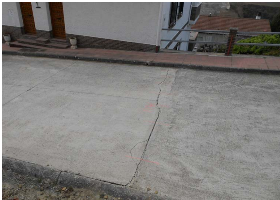
Figura 3.26: Vista de la grieta transversal observada en le calle 4 de la Urbanización Lasaitasuna, que corresponde a la grieta intermedia situada a una distancia creciente de 50 a 100 m respecto a la que constituye el límite Oeste. Provoca daños en viales, muros y viviendas.
