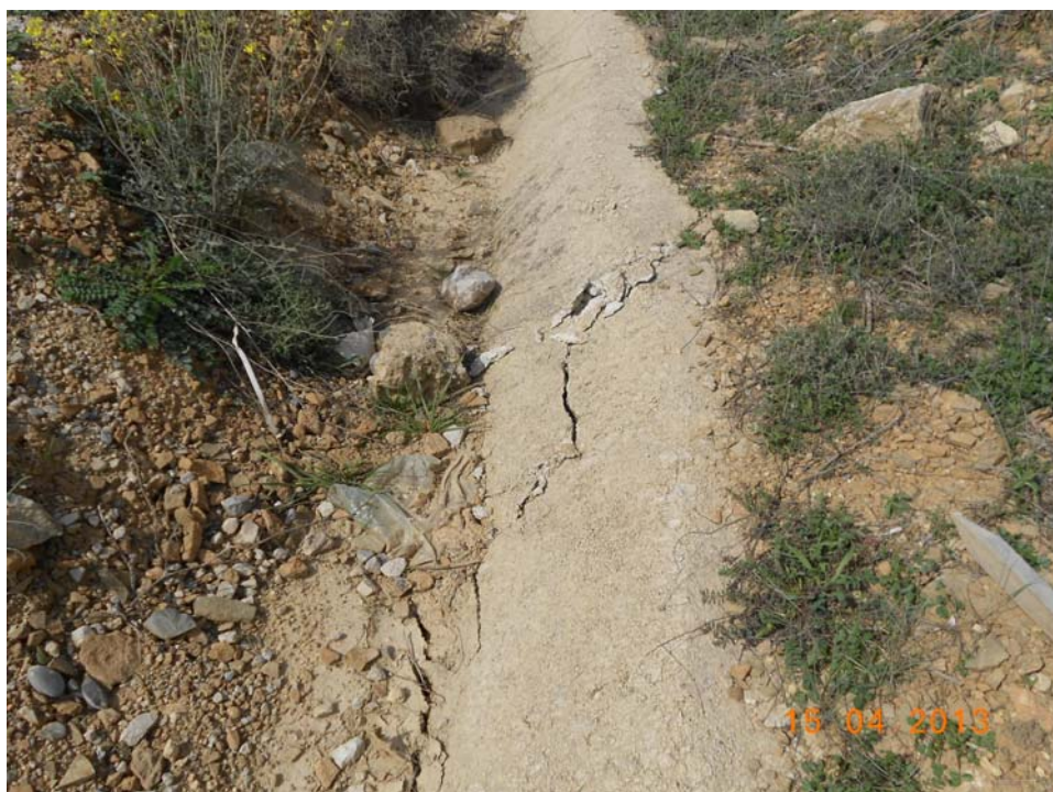
Figura 3.29: La grieta intermedia recorre toda la Urbanización Lasaitasuna, de N a S, provocando grietas transversales en viales y en construcciones anexas a las viviendas. No se observa en la CN-240, salvo por una apertura lateral en una junta del aglomerado (figura 3.12), volviendo a observarse en un camino que discurre aguas abajo de la CN-240, en una cuneta de hormigón
