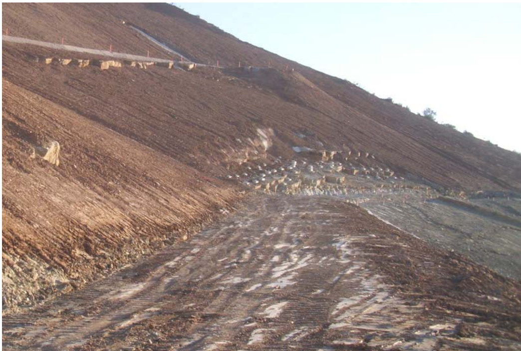
Figura 3.42: Vista hacia el Este de la berma nº 5 en la que se produjo un deslizamiento a favor de un repliegue local durante la excavación.
