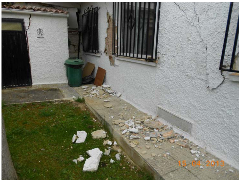
Figura 3.27: Vista de los daños provocados por la grieta intermedia en la fachada del patio de la vivienda situada entre las calles 3 y 4.
