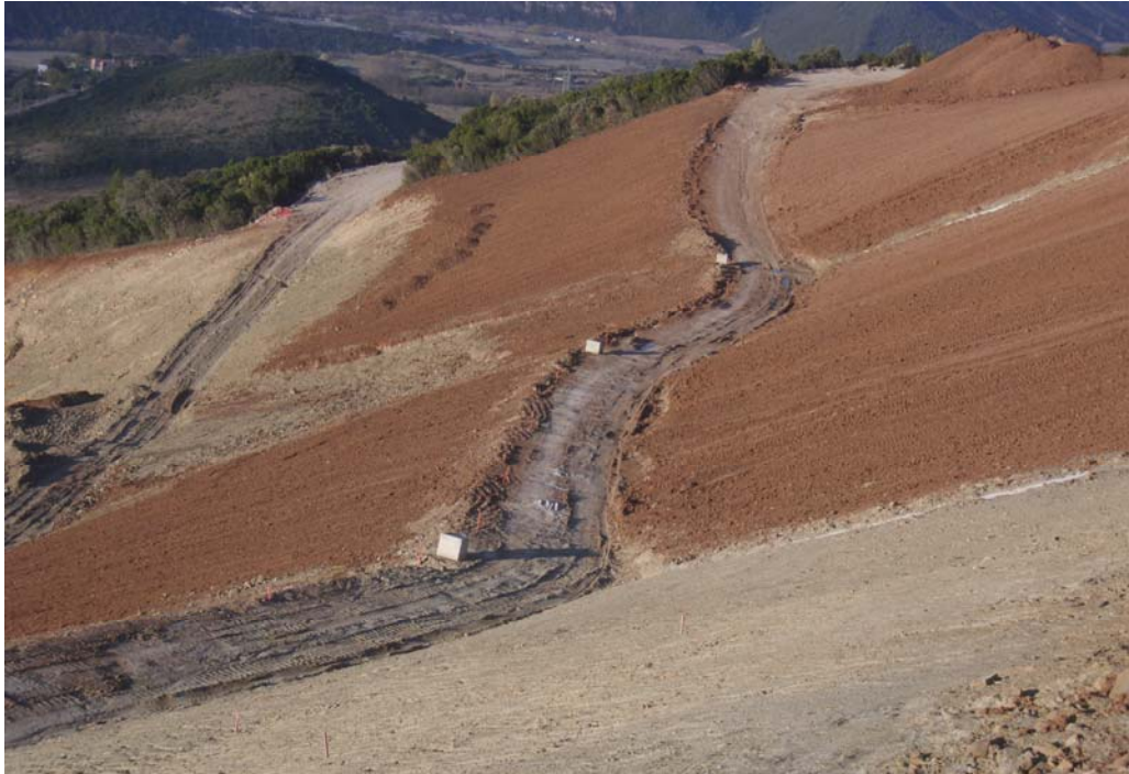
Figura 3.45: Detalle de la berma nº 4 hacia el Oeste donde se sitúa la coronación de un deslizamiento superficial que afecta a los bancos nº 3 y nº 4 (entre las bermas nº 2 y nº4).
