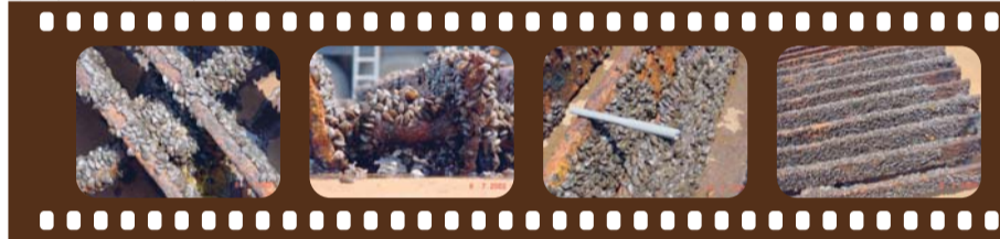
Rejas de la presa de Ribarroja colonizadas por mejillón cebra
